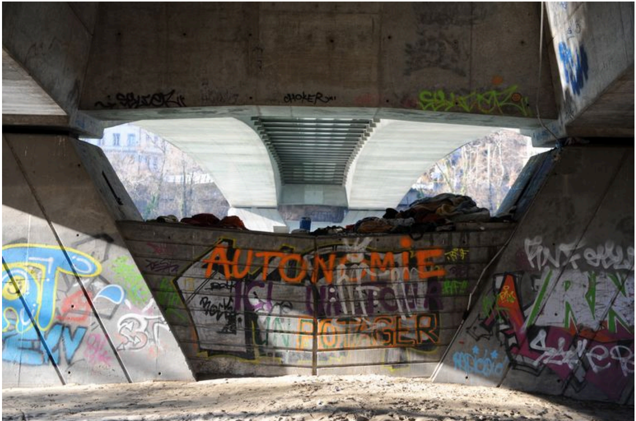
Tablier et pile, de dessous, vue partielle : jonction (depuis la rive gauche)
