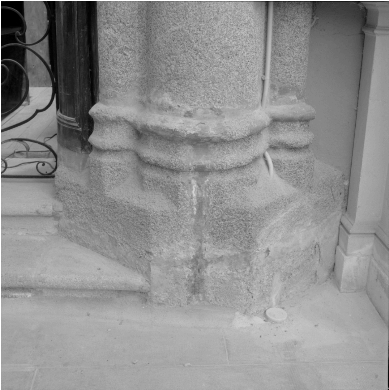
Détail de la base de la pile sud à l'entrée du chœur.
