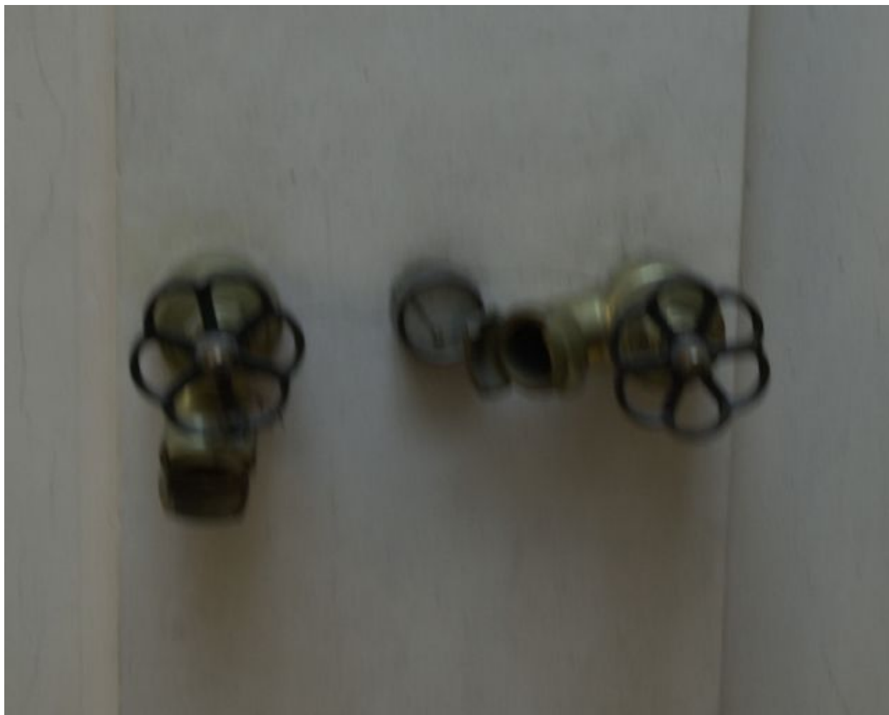
Vannes à incendie
