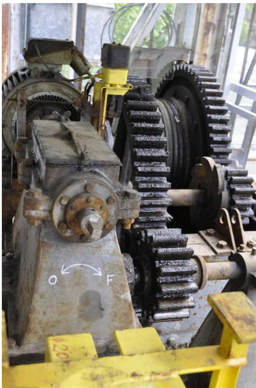
Détail du système hydraulique du barrage
