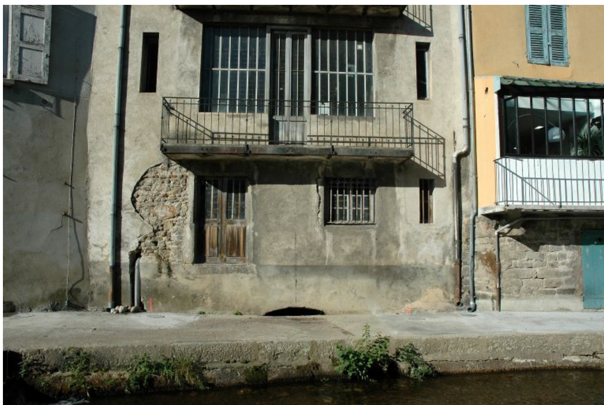
Vue du bief.
