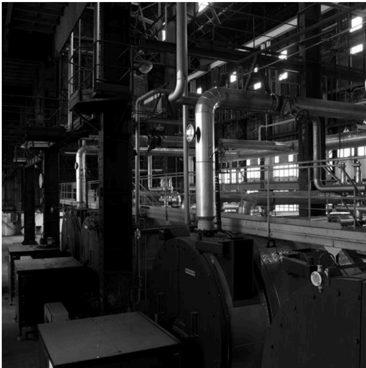
L'ensemble des chaudières
