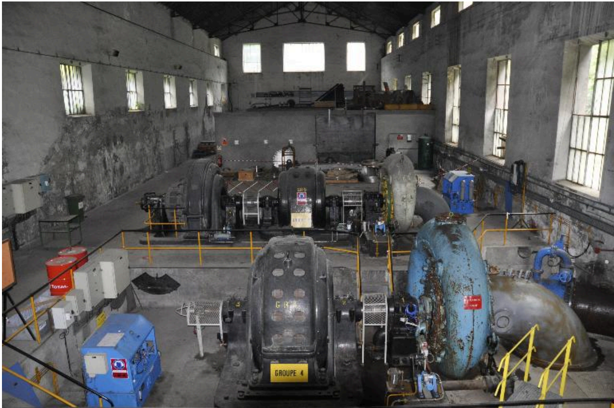
Vue d'ensemble de la salle des machines de Pierre-Eybesse II
