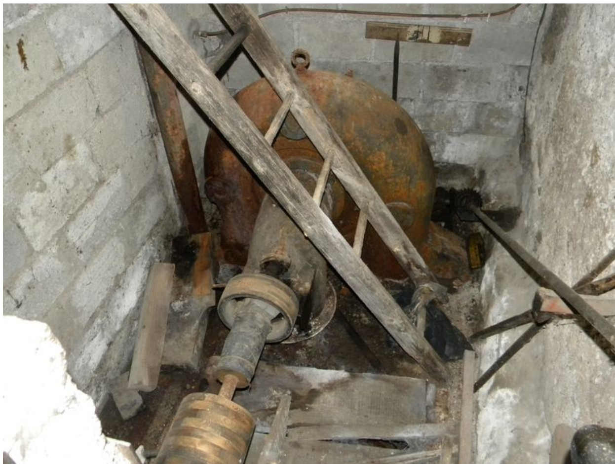
Vue de la turbine hydroélectrique.
