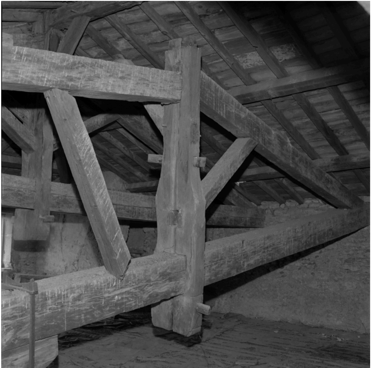
Corps de logis, charpente : détail d'une ferme affaissée.
