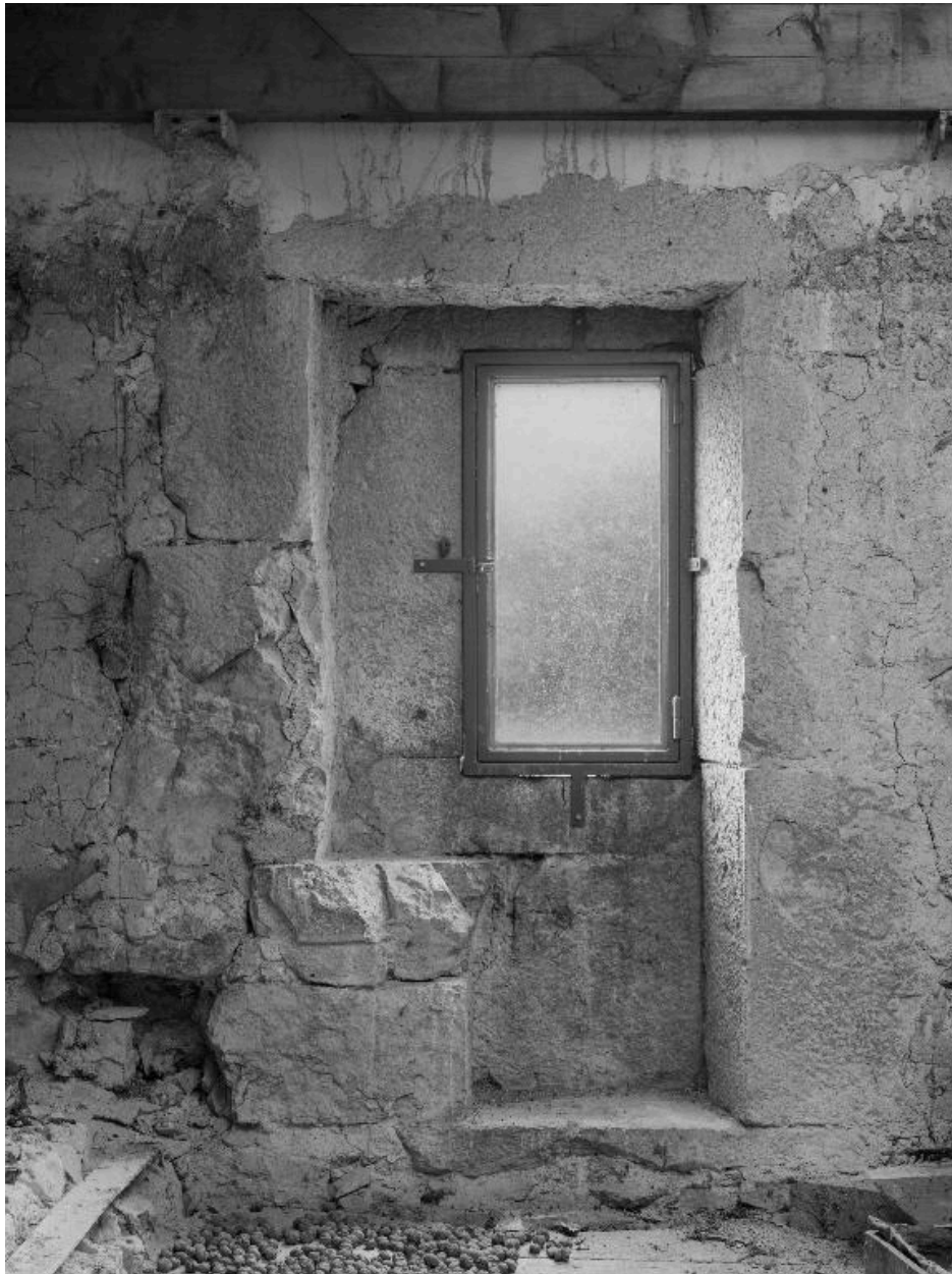
Vue intérieure du 2e étage de la tour, face sud-ouest : baie à coussiège.
