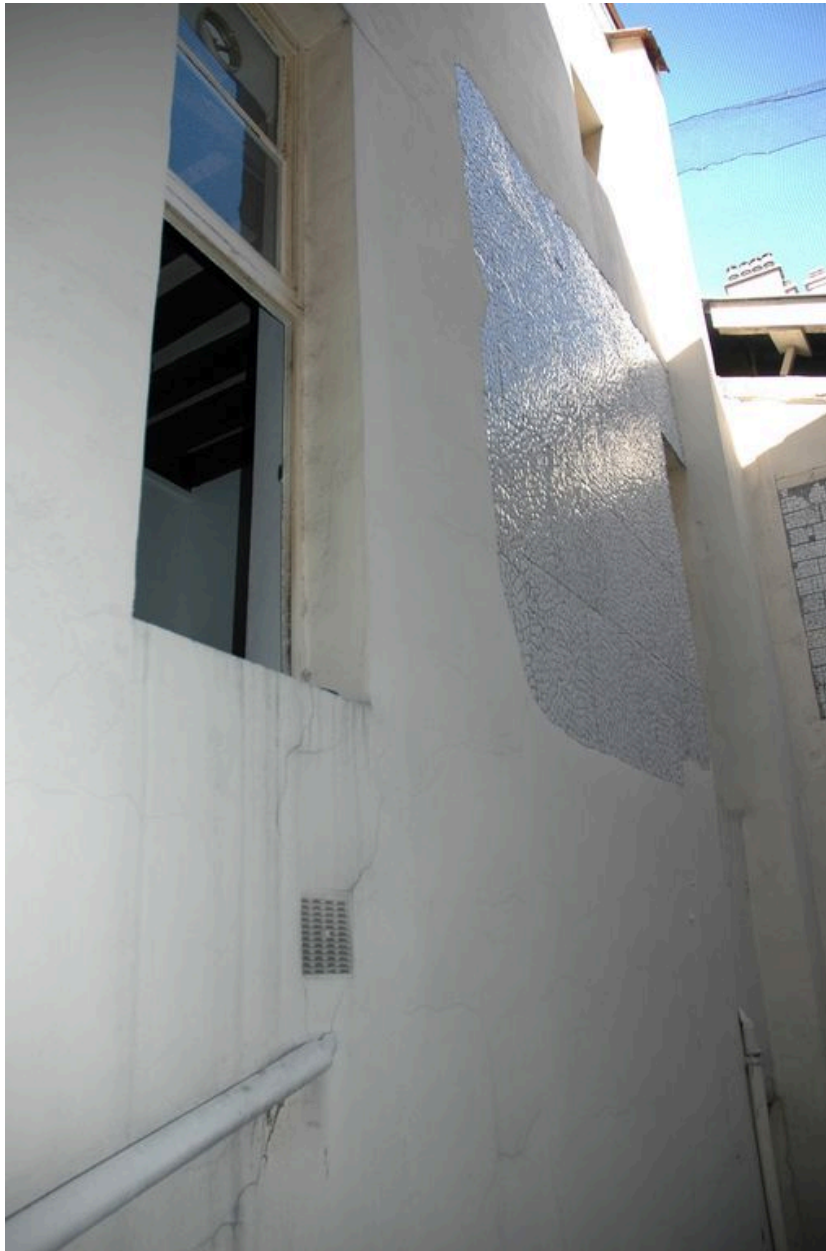
Petite cour située à l'ouest de la cage d'escalier du 105 grande rue de la Guillotière : élévation postérieure du 105
