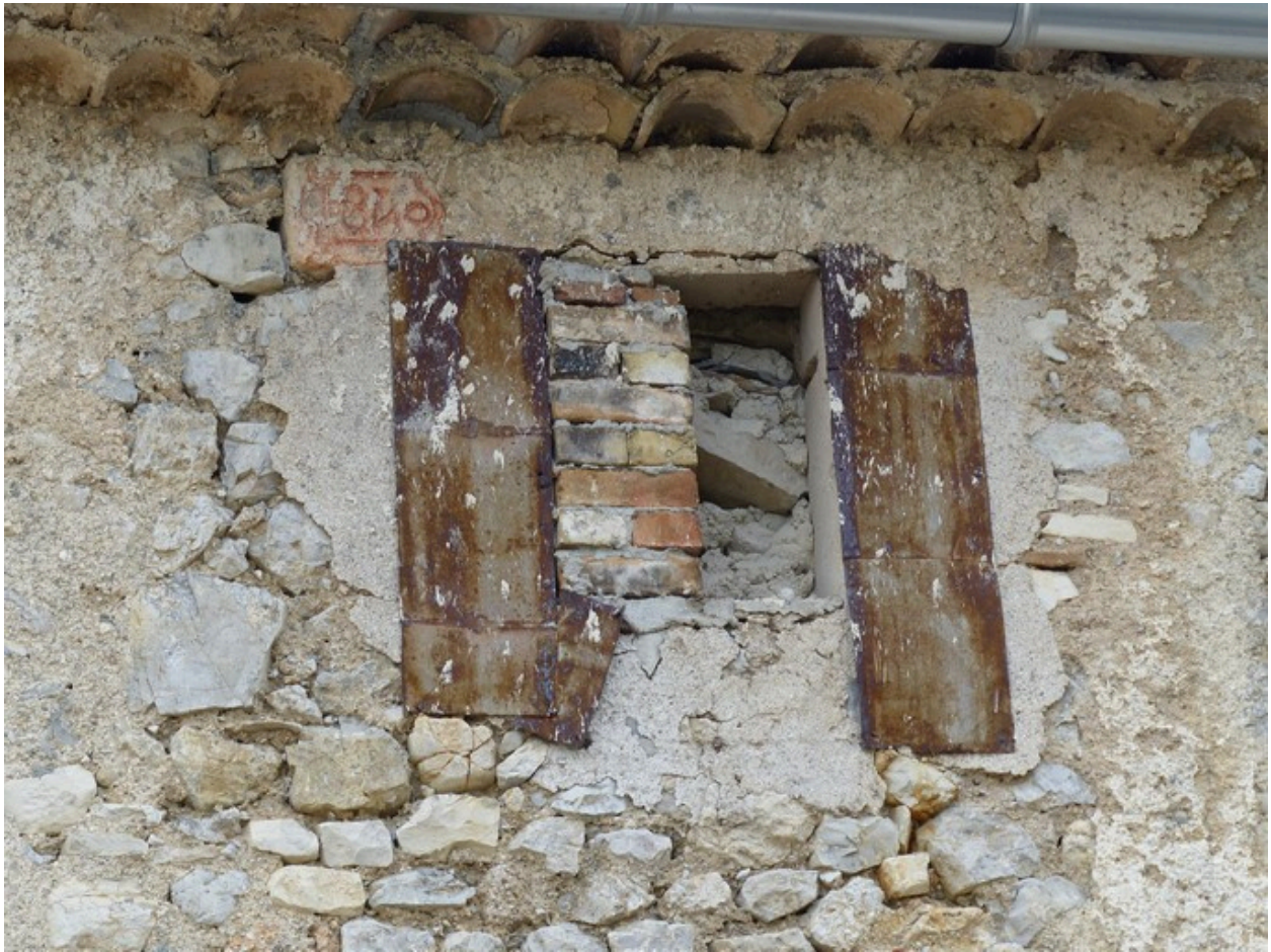
Baie d'envol de pigeonier (murée) avec plaques de tôle ; date porte gravée et peinte (1840). Ferme au Terron.
