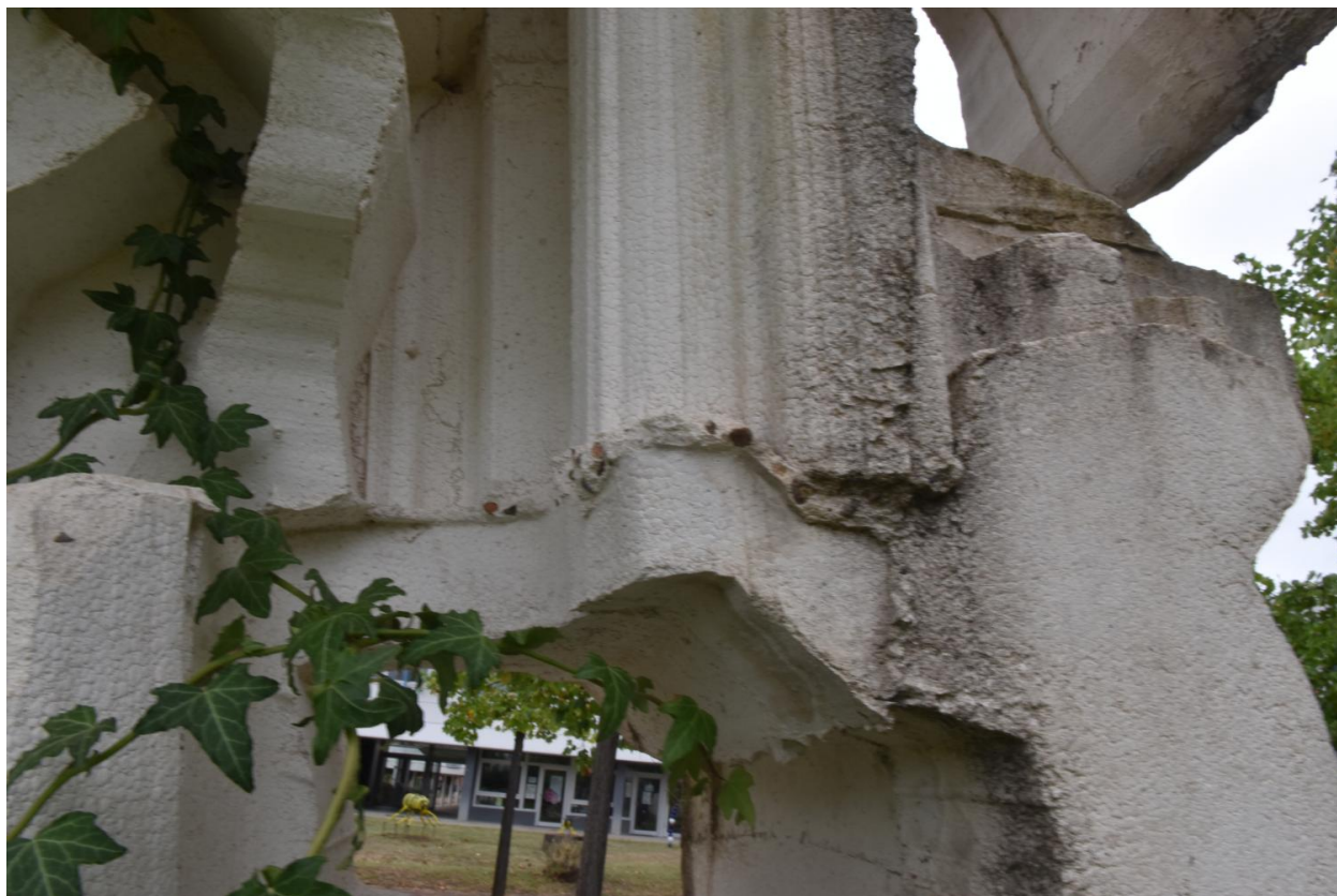
Détail des joints en ciment avec présence de graviers
