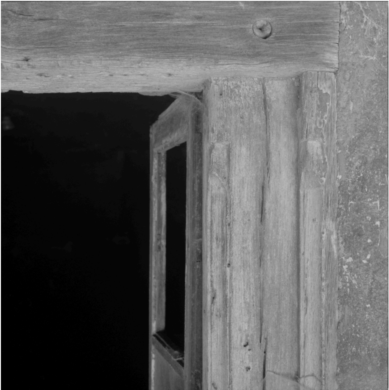
Logis ancien, vue de détail de la baie à encadrement mouluré de la cuisine du premier étage.
