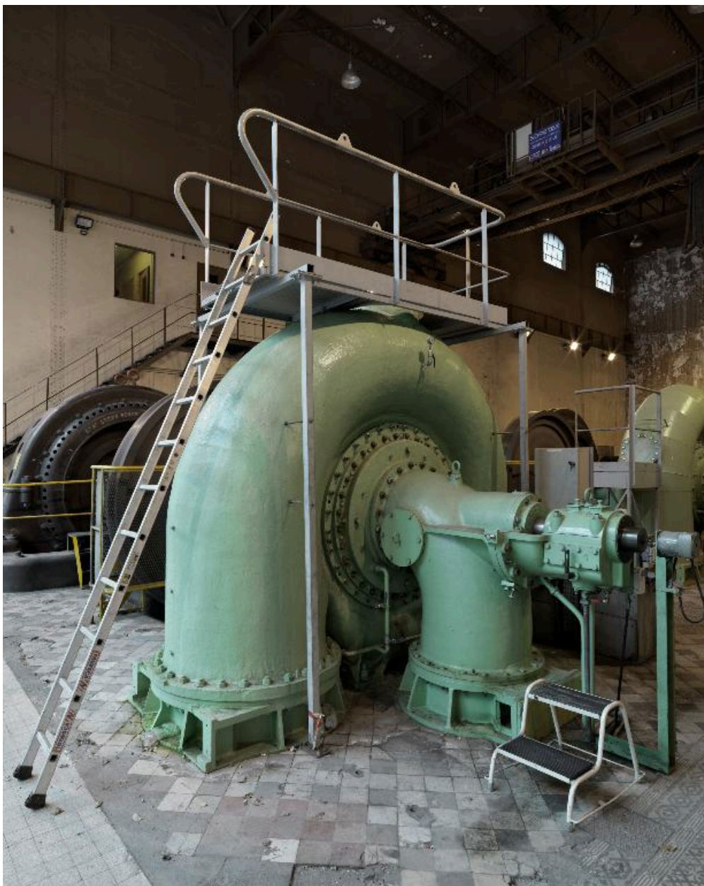
Vue d'une bache/turbine de la centrale de Livet
