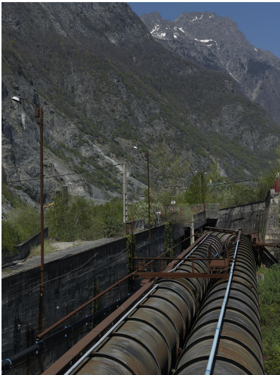
Conduites forcée de la centrale de Rioupéroux
